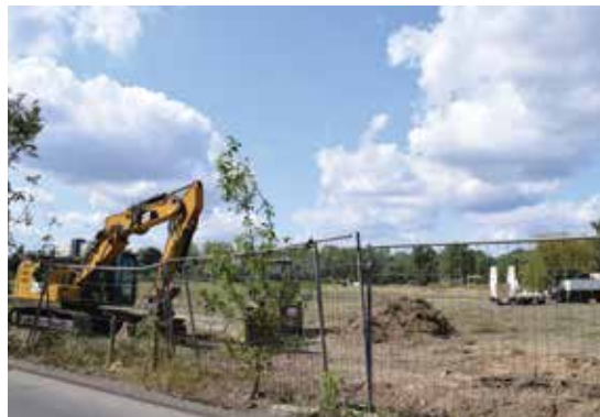
Auf dem ehemaligen Allkauf-Grundstück an der Märkischen Allee stehen die Bagger schon bereit.
