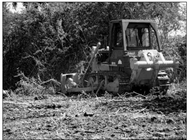
Der Cuba-Sí-Bulldozer knickt mit der Schaufel die Marabú-Stämme ab und zieht anschließend mit den Greifern die tief-liegenden Wurzeln aus der Erde. Foto: Cuba Sí
